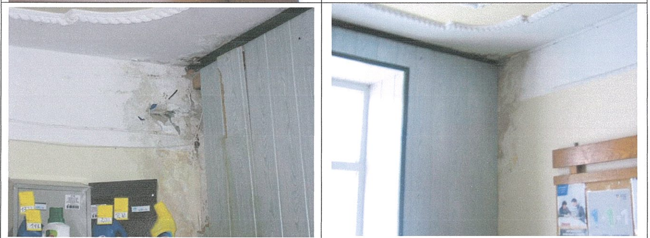
Dėl drėgmės pažeista pastato vidaus apdaila
